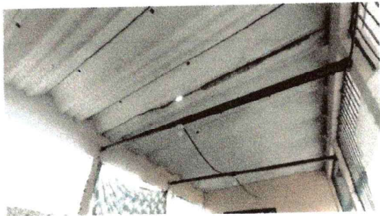
Foto 1: Sustrucción de lámina de Duralita por lámina troquelada, se observa la necesidad del cambio debido al tiempo y el estado de la misma
