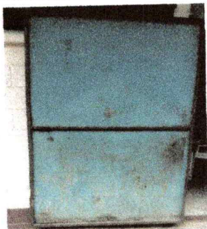
Foto 3: Se observa la necesidad de cambiar puerta debido a que nunca se ha cambiado solo se ha pintado y esta dañada
