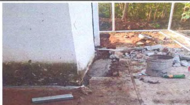
Foto 6: Se observa instalacion de grifo de agua
