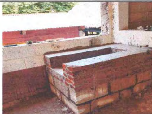
foto 14: Se observa perforacion de bano para ventana cocina
