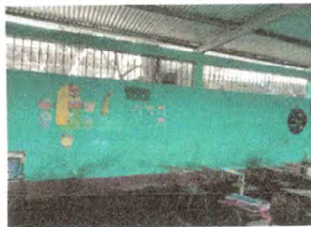
Foto 2: Se observa que la pared se encuentra en mal estado.
