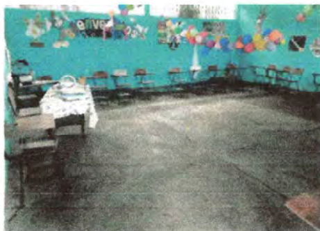
Foto 1: Se observa que el piso esta en malas condiciones.
