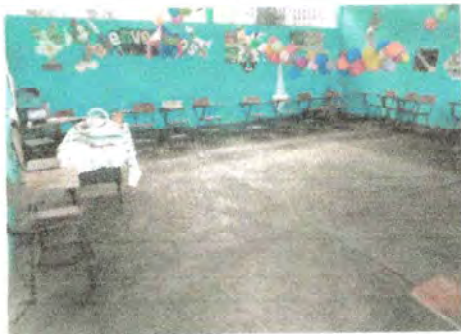
Foto 1: Se observa que el piso esta en malas condiciones.
