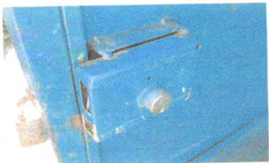
Foto 3: Chapa de la puerta de baños de maestros en mal estado.
