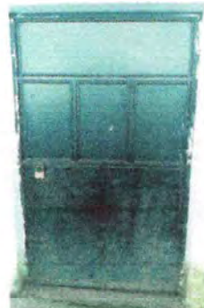
Foto 4: Puerta de la cocina en mal estado.
