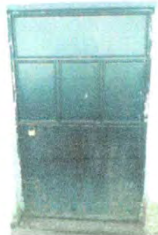
Foto 4: Puerta de la cocina en mal estado.
