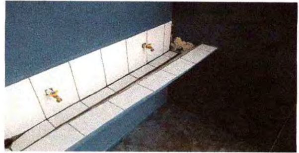
Foto 14: Se observa el cambio de chorros
