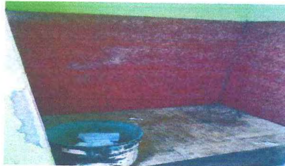
Foto 8: En mal estado Mingitorio
