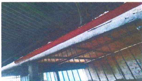
Foto 5: En mal estado bajada agua
