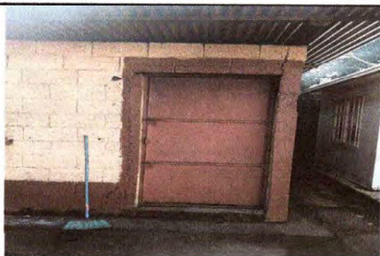
Foto 9: Se necesita dar mantenimiento a puerta de cocina
