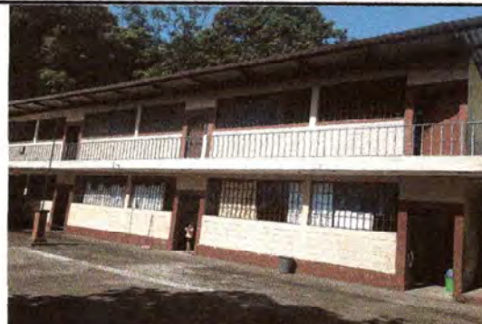
Foto 2: se ve la necesidad de pintar muros exteriores e interiores aulas de modulo I
