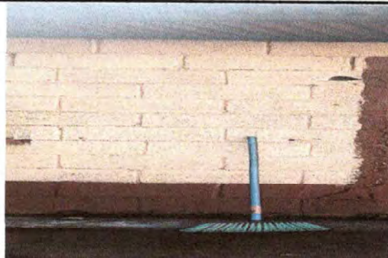
Foto 8: Se observa la necesida de pintar paredes de cocina
