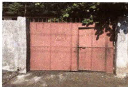
Foto 14: Se observa la necesidad de cambiar porton, esta sostenido con alambre
