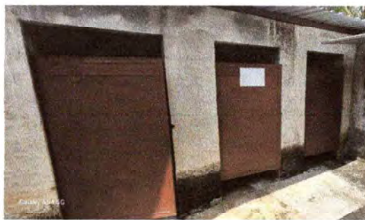
Foto 12: se observa la necesidad de colocar puertas en los sanitarios
