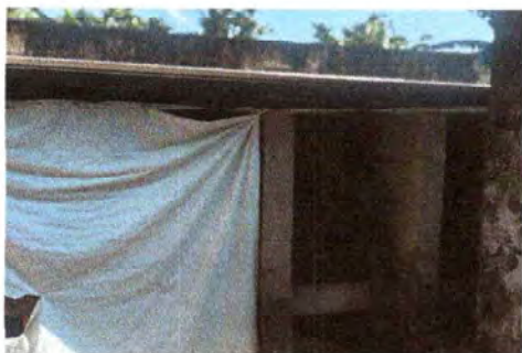
Foto 13: Se observa la necesidad de suministrar puerta a los migitorios
