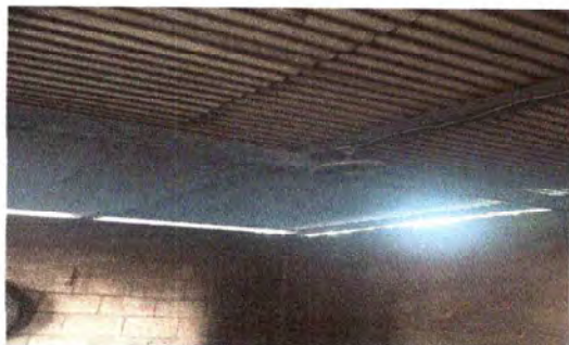
Foto 7: Se necesita sustituir el sistema electrico modulo Cocina
