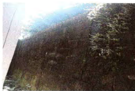
Foto 10: Se observa la necesidad de repellar el Muro Perimetral
