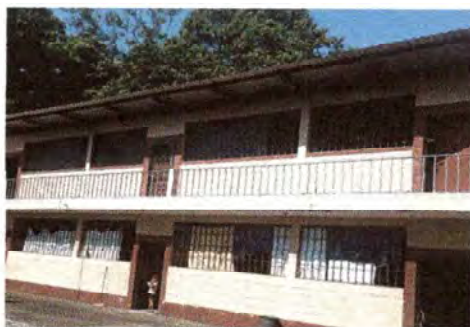
Foto 15 : Se observa la necesidad de colocar canal de metal y no perjudicar el aula
