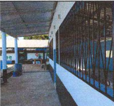
Foto 5: Se observa que los balcones fueron sustituidos en su totalidad.
