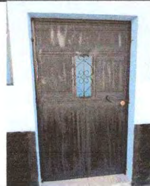
Foto 4: Se observa que la puerta del aula fue sustituida completamente.
