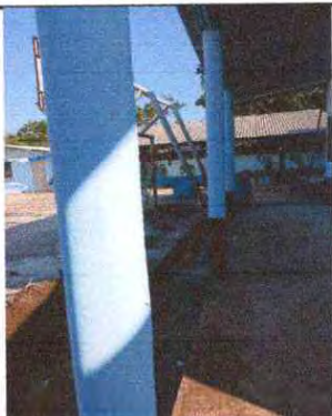
Foto 15: Se observa que las columnas se repararon con éxito.
