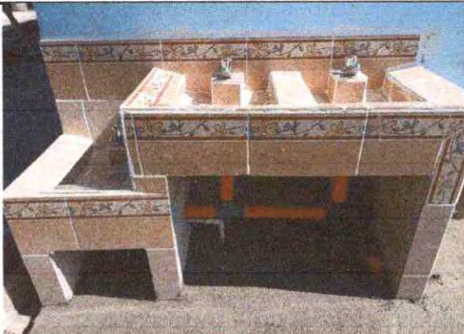
Foto 10: Se observa que se instalaron estaciones de lavado en los sanitarios para uso de los niños.
