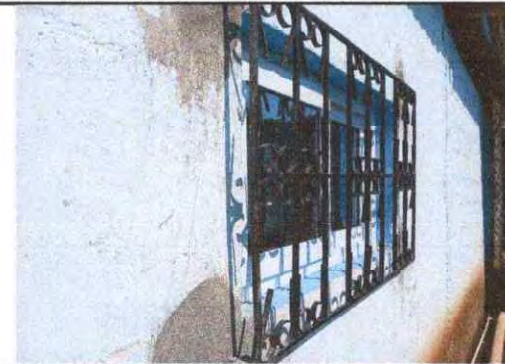
Foto 6: Se observa que en las aulas las ventanas de metal más vidrio fueron sustituidas en su totalidad.
