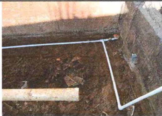
Foto 14: Se observa que la tubería principal, se removió por su mal estado y se colocará una nueva.
