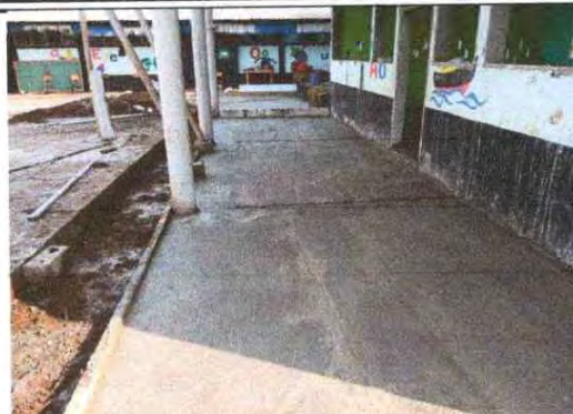
Foto 8: Se observa la falta de torta de concreto en area exterior del modulo I, se está sustituyendo.
