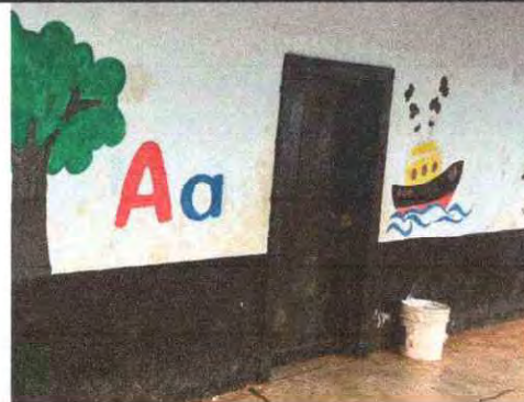
Foto 4: Se observa que la puerta del aula es necesario sustituirla
