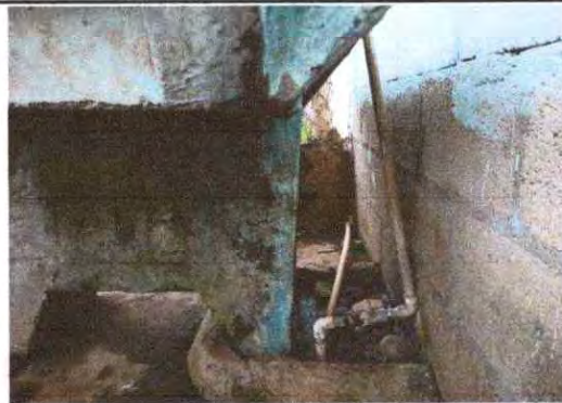
Foto 14: Se observa que la tubería principal, debido al paso de los años se ha deteriorado, la cual es necesario sustituirla.
