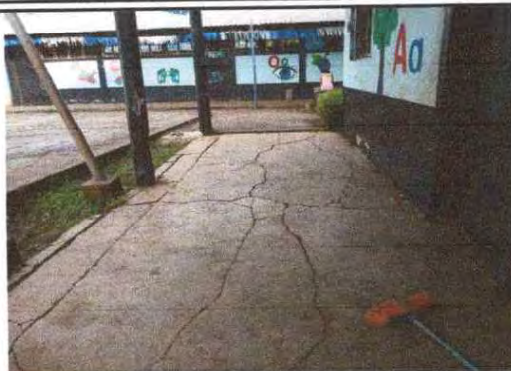
Foto 8: Se observa la falta de torta de concreto en area exterior del modulo I
