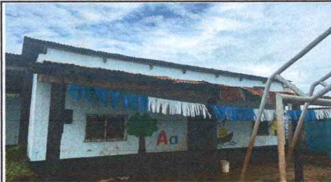
Foto 2: Se observa que las laminas del modulo I se encuentran con mucho óxido y en mal estado es necesario sustituir las.
