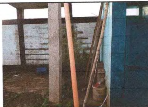
Foto 10: Se observa que es necesario la instalación de estaciones de lavado en los sanitarios para uso de los niños.
