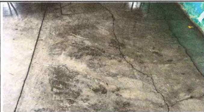
Foto 1: Se observa que el piso necesita ser sustituido por piso ceramico del modulo I
