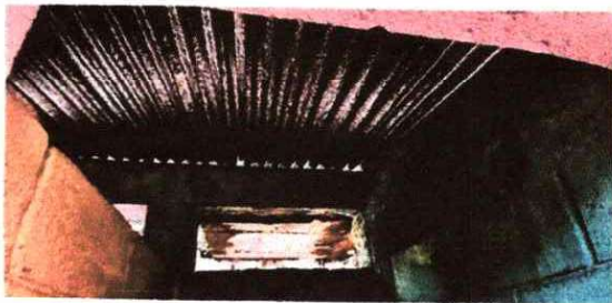
Foto 9: Se observa la necesidad de la estructura de metal
