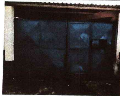
Foto 14 Se observa la necesidad de cambio del porton
