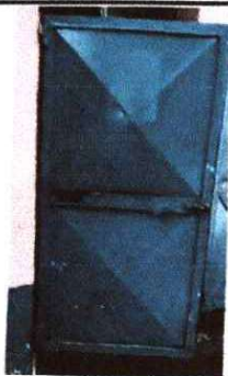
Foto 13: Se observa el mal estado de las puertas de metal
