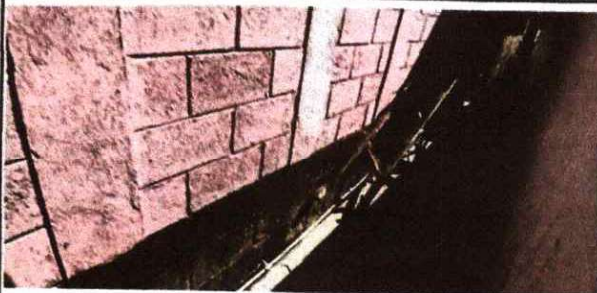
Foto 7: Se observa la necesidad de un migitorio de concreto para el uso de los niños
