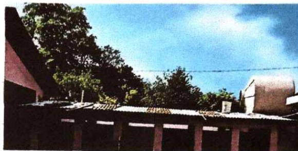
Foto 8: se observa el mal estado de la lamina por lo que es necesario el cambio
