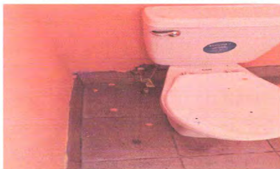
Foto 15: Se observa el mal estado de los sanitarios
