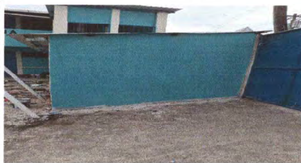
Foto 4: Se observa que falta conformar muro.
