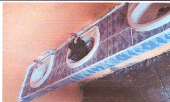
Foto 14: Se observa el mal estado de los lavamanos
