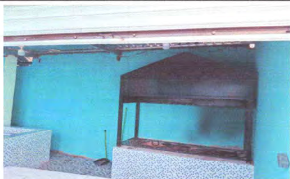
Foto 13: Se observa que falta pintura en los muros
