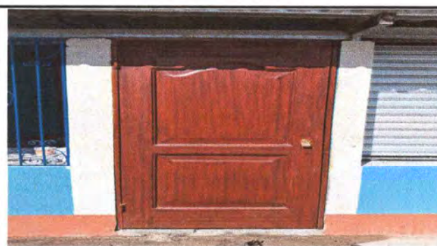
Foto 6: Se observa que falta puerta
