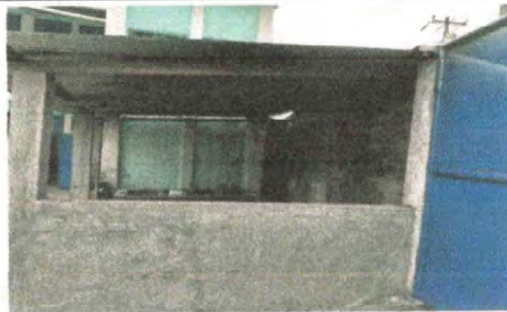
Foto 4: Se observa que falta conformar muro,
