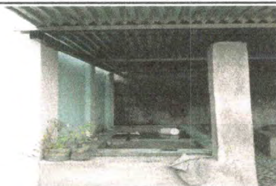
Foto 9: Se observa que falta balcon
