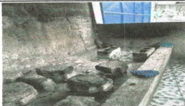
Foto 1: Se observa el mal estado de la estufa rural
