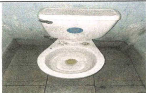
Foto 15: Se observa el mal estado de los sanitarios
