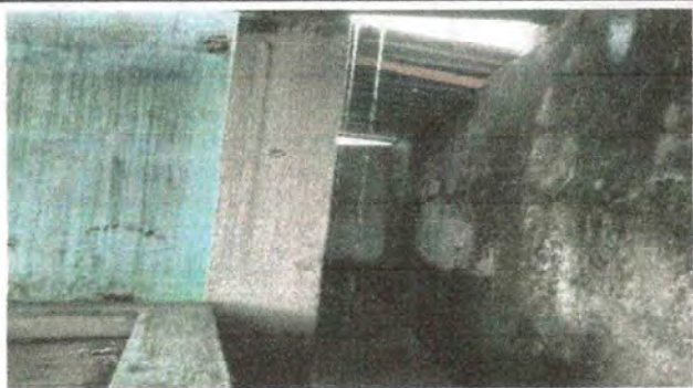
Foto 13: Se observa que falta pintura en los muros
