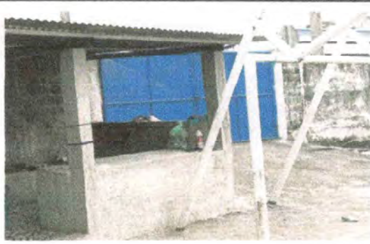
Foto 8: Se observa que falta ventana
