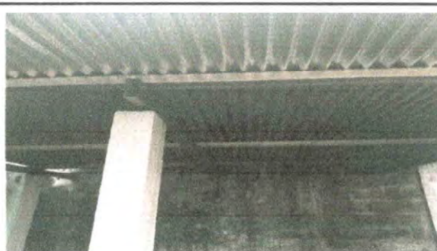
Foto 10: Se observa el mal estado de la lamina
