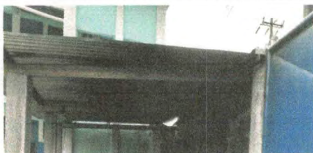
Foto 11: Se observa el mal estado de la estructura de soporte de metal
