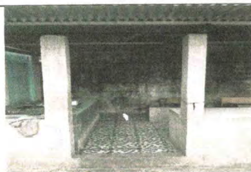
Foto 6: Se observa que falta puerta
