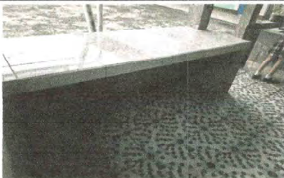
Foto 7: Se observa que falta puerta en gabinete
