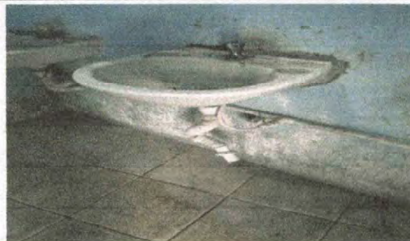
Foto 14: Se observa el mal estado de los lavamanos
