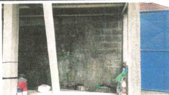
Foto 5: Se observa que falta repello en paredes de la cocina
