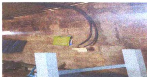
Foto 2: Repello de muro las paredes estan demasiado rústicas en la cocina.
