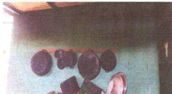
Foto 7: Resane y aplicación de pintura se observa que las paredes están en malas condiciones.
