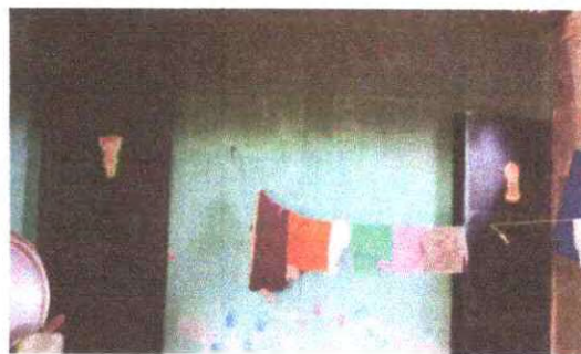
Foto 10: Sustitución puerta de servicio sanitario, las puertas están deterioradas.
