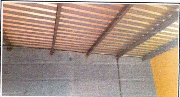
Foto 3: El techo está dañado y cae mucha agua en los escritorios
