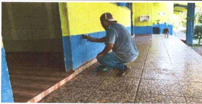
Foto 5: La pintura se esta levantando de la pared.
