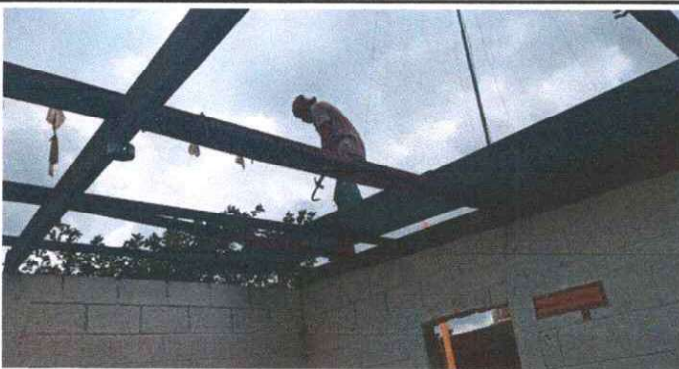
Foto 3: las costanetas estan oxidadas y picadas
