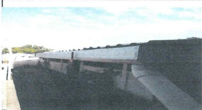
Foto 3: Suministro de canales y caída de agua
