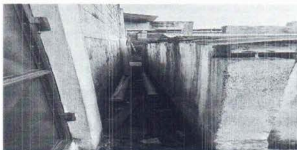
SE NECESITA RESANE Y PINTURA EN MURO PERIMETRAL PARA MEJORAMIENTO
