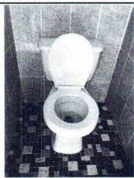
Foto 10: Se necesita reparar el inodora, ya que no funciona correctamente ni retiene el agua.
