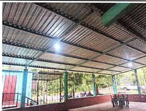
Foto 2: Se observa sistema electrico establecido.
