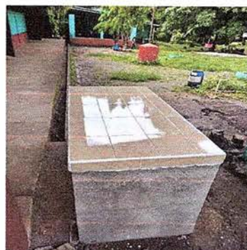
Foto 4: Se observa mueble de cocina instalado.
