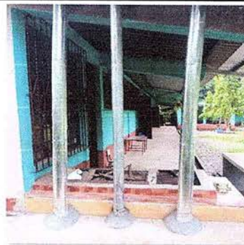
Foto 6: Se observa chimenea instalada.
