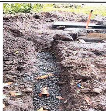
Se observa zanja de absorción tipo frances.
