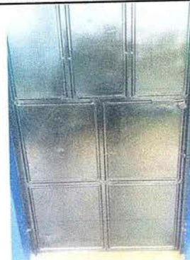
Foto 8: Se observa que el mantenimiento a las puertas se esta realizando
