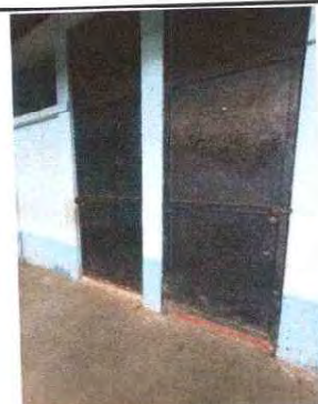
Foto 4: Se observa la falta de sustitucion de chapa, ya que las que existen estan aruinadas
