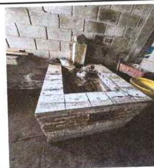
Foto 12: Se observa la falta de componentes en la estufa rural como: chimenea de metal
