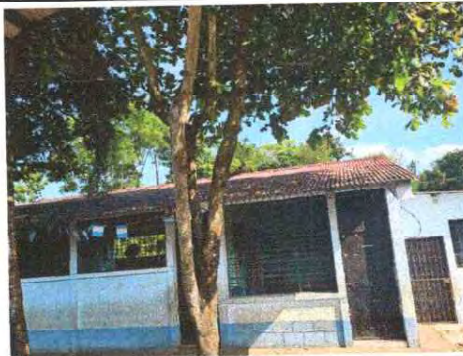
Foto 14: Se observa la pintura del establecimiento en mal estado
