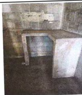
Foto 10: Se observa la falta de piso de azulejo en areas de muebles de cocina para ocultar las imperfecciones
