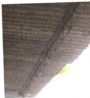
Foto 2: Se observa que la estructura requiere mantenimiento
