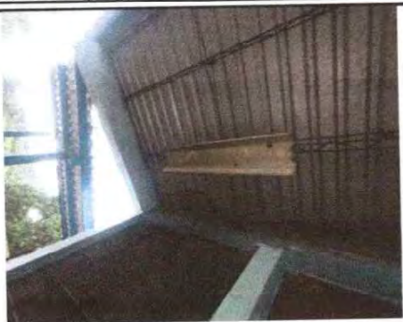
Foto 13: Se observa la falta de luminarias en el area y correcciones en el sistema electrico
