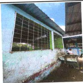
Foto 5: Se observa la necesidad de ventana de pvc para proteger de la lluvia
