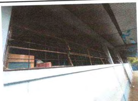
Foto 3: Se observa el balcon en mal estado
