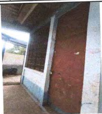
Foto 7: Se observa la falta de pintura para una mejor estética, y resanar partes dañadas de la pared
