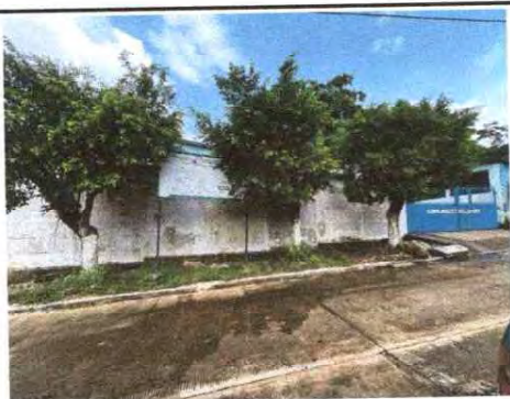
Foto 15: Se observa la falta de pintura en muro perimetral
