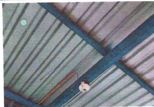
Foto 2: Estructura de techos con presencia de oxido, se requiere mantenimiento.
