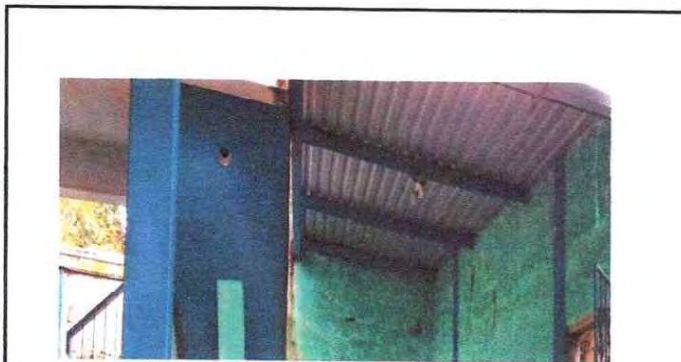
Foto 15: se observa que la estructura ya se encuentra picada por lo que requiere sustitución
