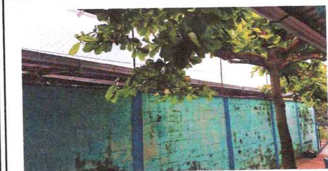
Foto 1: Malla de muro perimetral en mal estado, por seguridad se requiere sustitución.
