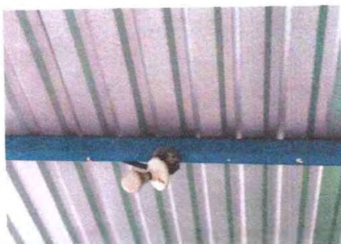
Foto 3: En varias áreas del establecimiento se encuentra el sistema eléctrico dañado, corriendo riesgo de corto circuito, se necesita mantenimiento.
