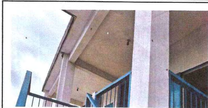
Foto 13: en esta parte del módulo, cuando llueve entra el agua por lo que es necesario colocarle vicerias con lámina
