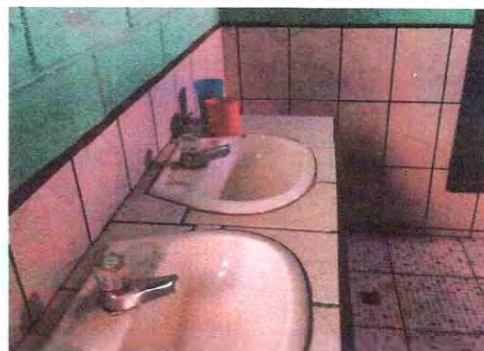
Foto 8: Lavamanos en malas condiciones, se requiere cambio de chorro, contrallave y tubería de abasto de agua.
