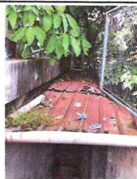
Foto 12: se requiere sustitución de estructura de madera por metal.
