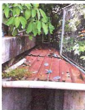
Foto 11: Se puede observar la lámina del área de bodega deteriorada, se requiere sustitución de estructura de madera por metal y sustitución de lámina.
