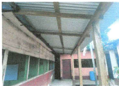
Foto 4: Se observa que la lamina del pasillo fueron cambiadas
