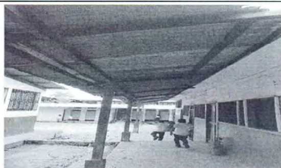
Foto 4: Se observa que la lamina del pasillo necesita ser cambiada
