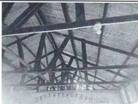
Foto 1: Se observan que la estructura soporte de madera de módulo 1 necesita mantenimiento
