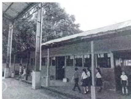
Foto 2: Se observa que las laminas estan en mal estado y necesitan sustituirse
