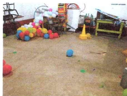
Foto 2: Se observa que el piso de los salones son de torta de cemento por lo que es necesario sustituirlo por piso cerámico.
