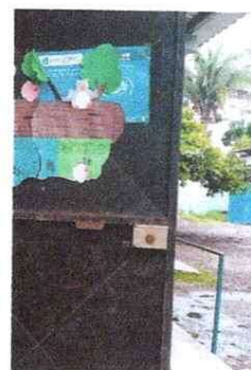
Foto 4: Se observa que las chapas de las puertas se encuentran en mal estado y por ello es necesario sustituirlas.
