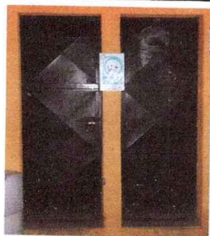
Foto 11: Se observa que la pintura de las puertas de los sanitarios se encuentran deterioradas por lo que requiere brindarle mantenimiento.
