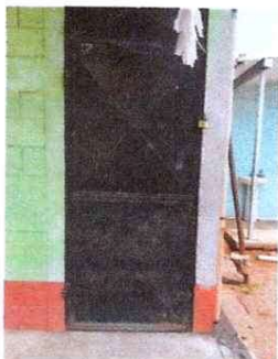
Foto 1: Se observa que las puertas de los salones se encuentran con la pintura deteriorada y por ello es necesario brindarles mantenimiento.
