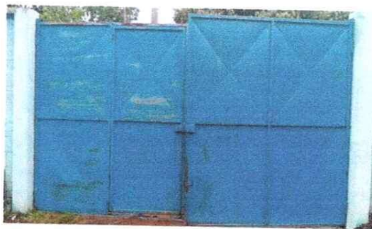
Foto 7: Se observa que el porton de ingreso al establecimiento la pintura se encuentra deteriorada por que lo es necesario brindarle mantenimiento.
