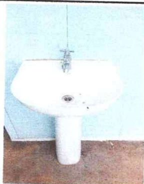
Foto 13: Se observa que el centro educativo cuenta con una sola estación de lavado por lo que es necesario sustituirlo por una nueva estación de lavado.
