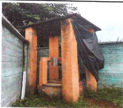
Foto 9: Se observa que el pozo requiere de una bomba para poder llenar el deposito que abastecera del vital liquido a los baños y pileta.
