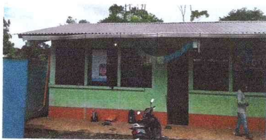
Foto 3: Se observa la pintura deteriorada de los salones por lo cual requiere mantenimiento.
