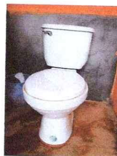
Foto 12: Se observa que el sanitario ya se cuenta en malas condiciones y que ya no es apto para su uso, por lo cual requiere sustitución.
