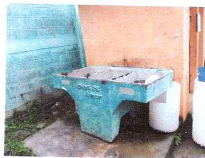
Foto 10: Se observa que la pileta y los sanitarios no cuentan con tubería para el llenado y vaciado del agua.
