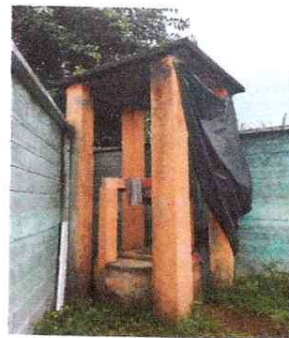
Foto 8: El deposito de agua fue robado, por lo que es necesario sustituirlo para poder contar con el vital liquido dentro del establecimiento.
