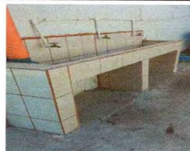
Foto 18: se observa que se realizó la estación de lavado.
