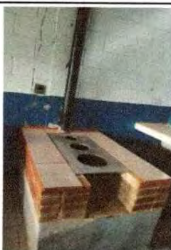
Foto 15: se observa que se realizó la sustitución de la estufa.
