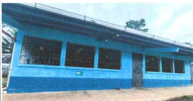
Foto 9: se observa que el modulo ya su pintura se encuentra en deterioro por lo que se debe pintar de nuevo.
