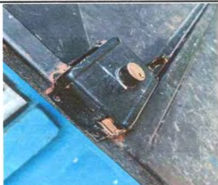
Foto 7: se observa que la chapa ya se encuentra en malas condiciones por lo que requiere el cambio.
