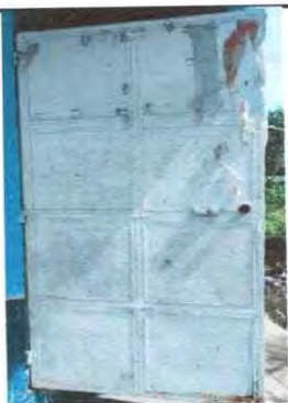
Foto 21: se observa que las puertas de los salones ya no se encuentran en buen estado por lo que requiere sustitución.
