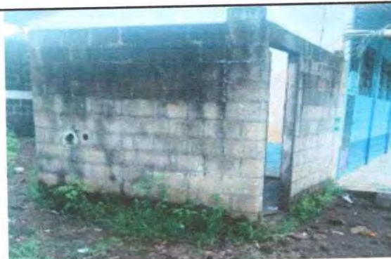
Foto 4: se observa que el modulo requiere repello para que no se filtre el agua.
