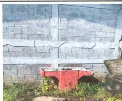
Foto 18: se observa que la pila ya se encuentra en pesimas condiciones, por lo que es necesario colocar una estación de lavado nueva.
