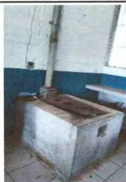
Foto 15: se observa que la estufa rural ya no se encuentra en buenas condiciones por lo que se debe realizar una nueva.
