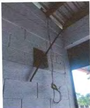
Foto 19: Se observa que el sistema eléctrico ya no funciona bien por lo que requiere sustitución.
