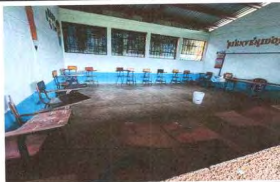
Foto 22: se observa que el piso del salón de clase no cuenta con piso adecuado para que el estudiante pueda recibir las clases.
