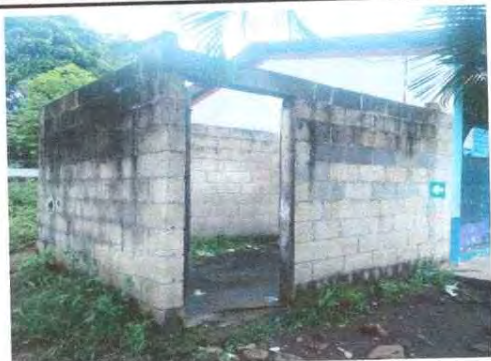
Foto 1: Se observa que el modulo no cuenta con lamina por lo que se requiere que se le coloque para que empiece a funcionar.
