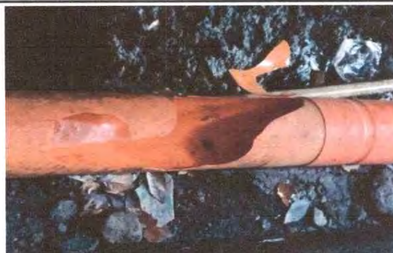
Foto 10: se observa las malas condiciones de la tubería que transporta las aguas negras.
