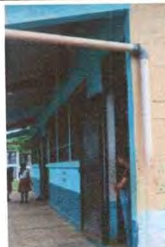
Foto 20: se observa que la tubería de bajada de agua ya no se encuentra en las condiciones para su funcionamiento.
