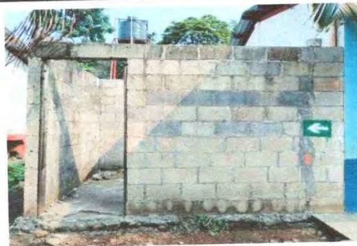
Foto 2: Se observa que el modulo no cuenta con estructura de soporte para poder colocar las laminas.
