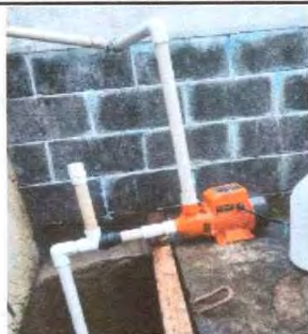
Foto 13: se observa que la bomba de agua ya no funciona de manera correcta, por lo que requiere sustitución.
