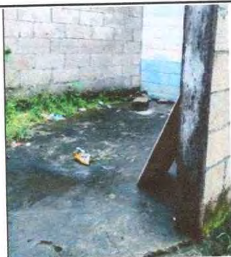
Foto 3: se observa que se requiere colocar piso ceramico para buen funcionamiento.
