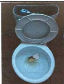
Foto 17: se observa que el inodoro ya no se encuentra en buen estado y requiere cambiarlo.
