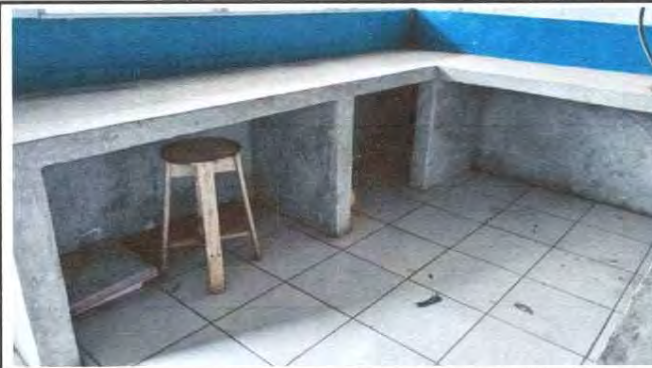
Foto 16: se observa que los muebles de la cocina no se encuentran en las condiciones adecuadas para su utilización.
