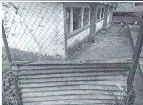
Foto 9: Se observa que el mal estado de otro portón de acceso a módulo de aulas
