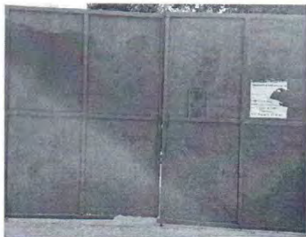
Foto 7: Se observa el portón de metal en mal estado, urge sustituirlo
