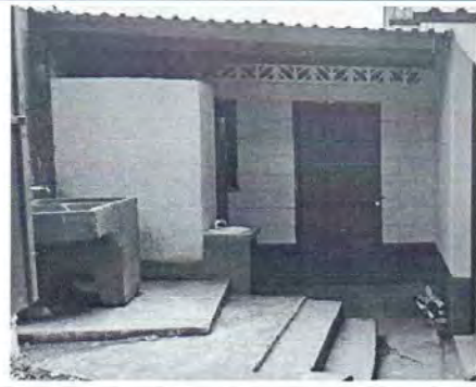
Foto 2: Se observa la necesidad de canchales de agua pluvial en área de pila
