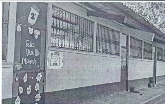
Foto 8: Se observa que muros exteriores e interiores necesitan mantenimiento preventivo
