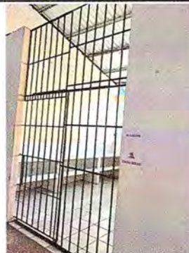
Foto 4: Puerta de rejilla o baranda en la cocina.
