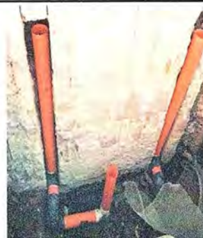
Foto 6: Línea principal de drenaje.
