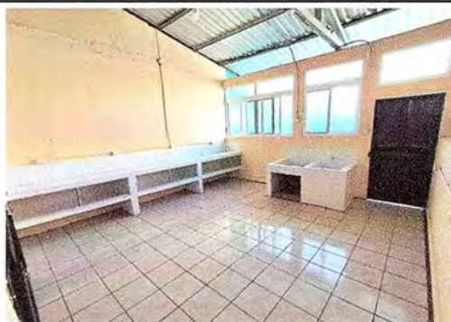
Foto 10: Paredes pintadas por completo.
