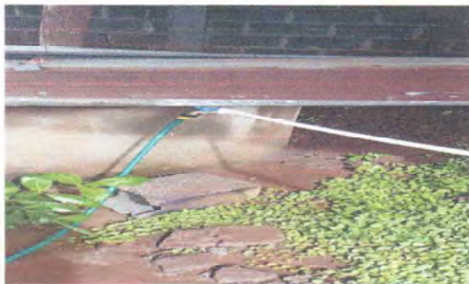
FOTO 7: Se observa que la tubería que alimenta el pozo artesanal o depósito de agua se encuentra en mal estado.
