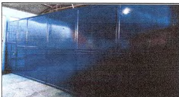
Foto 4: Se observa sustitución de puertas en peldaño en mal estado
