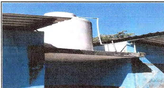
Foto 9: Se observa accesotío de ded depósito cambiados
