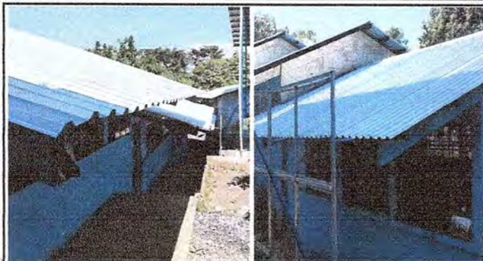
Foto 1: Se observa techo que estaba en mal estado ahora totalmente cambiado
