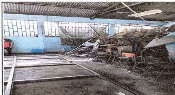
Foto 4: Se observa el trabajo de puertas en mal estado
