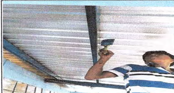
Foto 2: Se observa el trabajo en la estructura del techo que estaba en mal estado
