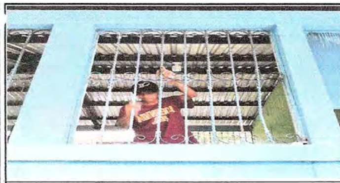
Foto 5: Se observa el trabajo en balcones en mal estado
