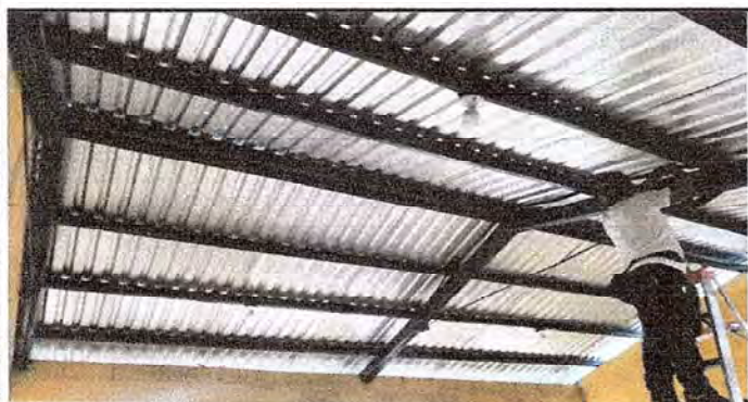
Foto 3: Se observa el trabajo en el sistema eléctrico que estaba en mal estado
