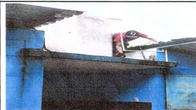
Foto 9: Se observa accesorios en mal estado
