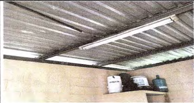
Foto 7: Se observa sistema eléctrico de la cocina en mal estado
