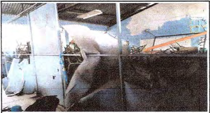
Foto 4: Se observa puertas en mal estado
