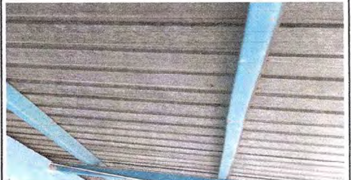
Foto 2: Se observa la estructura de techo en mal estado
