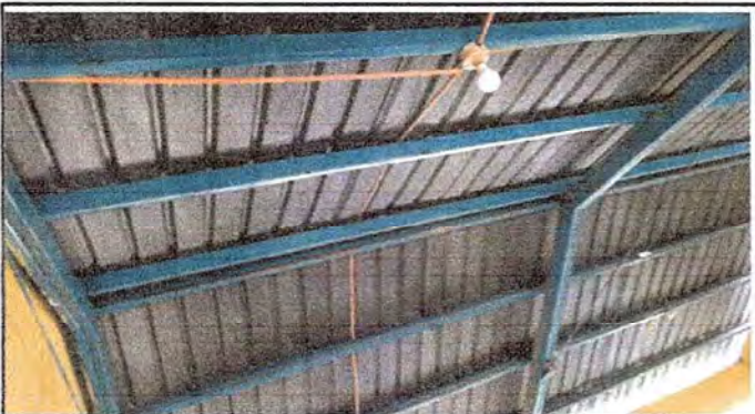
Foto 3: Se observa sistema eléctrico en mal estado
