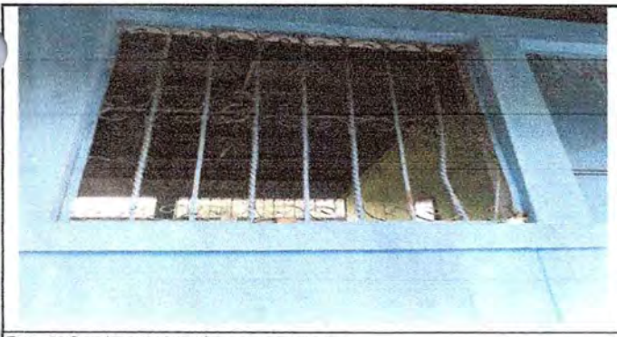
Foto 5: Se observa balcón en mal estado
