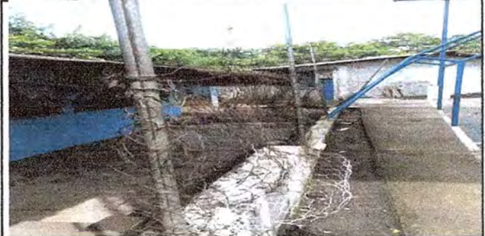
Foto 8: Se observa muro perimetral de malla en mal estado
