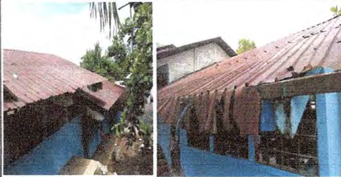
Foto 1: Se observa techo de lámina en mal estado
