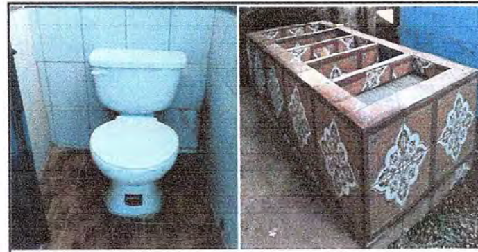
Foto 6: Se observa azulejo colocado
