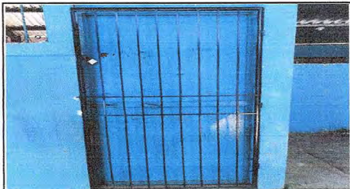
Foto 3: Se observa puerta de reja de 1x2
