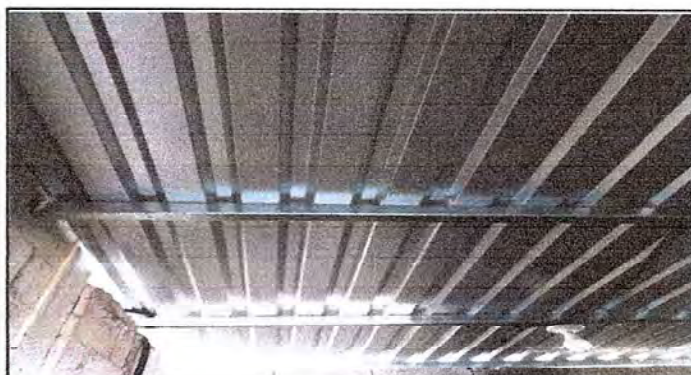
Foto 10: Se observa estructura cambiada
