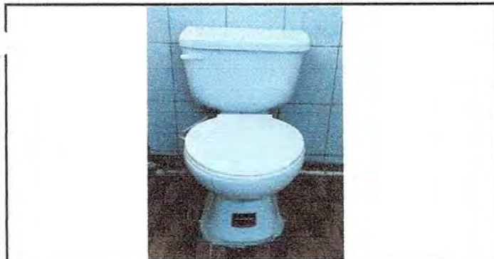
Foto 5: Se observa inodoro cambiado
