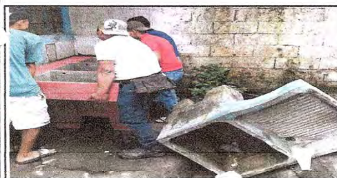
Foto 11: Se observa trabajo depila en mal estado
