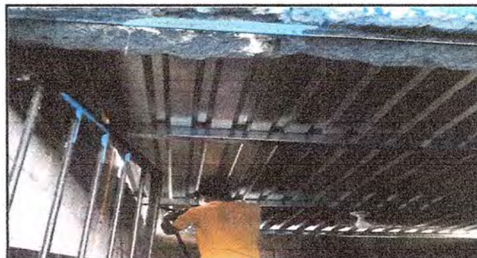
Foto 10: Se observa trabajo de estructura en mal estado
