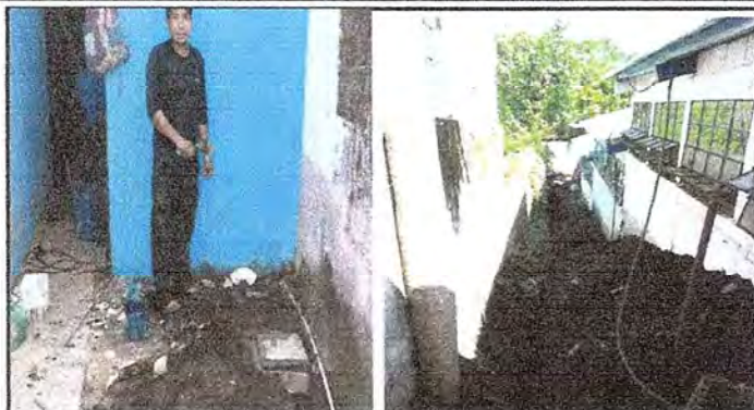
Foto 7: Se observa el trabajo del drenaje en mal estado módulo 2
