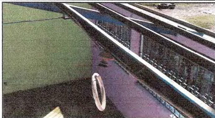
Foto1: Se observa desmontaje de techo de lamina en mal estado
