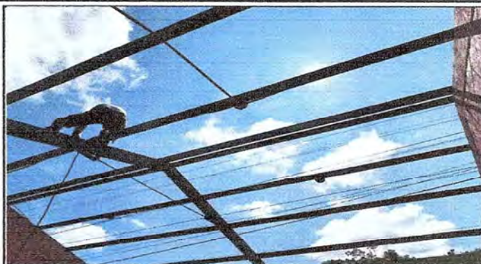
Foto 2: Se observa el trabajo en la estructura de techo en mal estado
