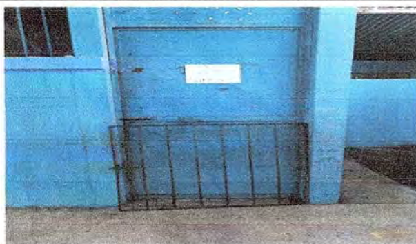
Foto 3: Se observa la necesidad de cambiar por una puerta de reja de 1 x 2 metros
