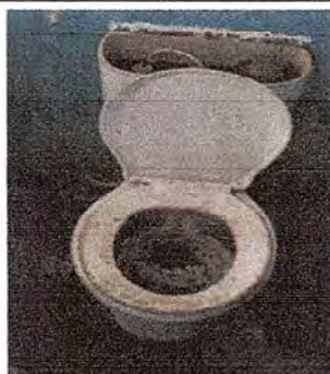
Foto 5: Se observa inodoros en mal estado
