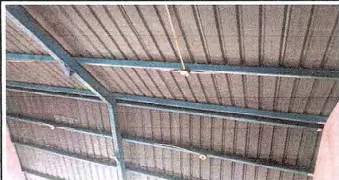
Foto 2: Se observa la necesidad de dar mantenimiento en módulo 1
