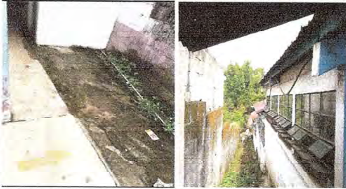
Foto 7: Se observa el drenaje en mal estado módulo 2
