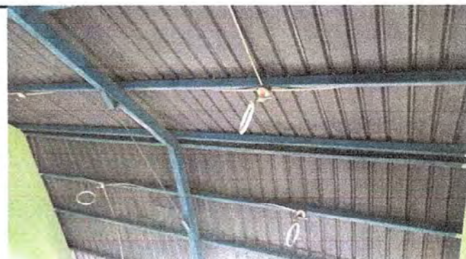
Foto 4: Se observa sistema eléctrico en mal estado
