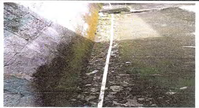
Foto 8: Se observa la necesidad de cajas de registro módulo 2
