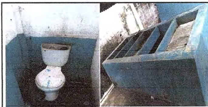
Foto 6: Se observa la necesidad de azulejos
