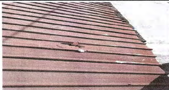
Foto 1: Se observa techo de lamina en mal estado en módulo 1
