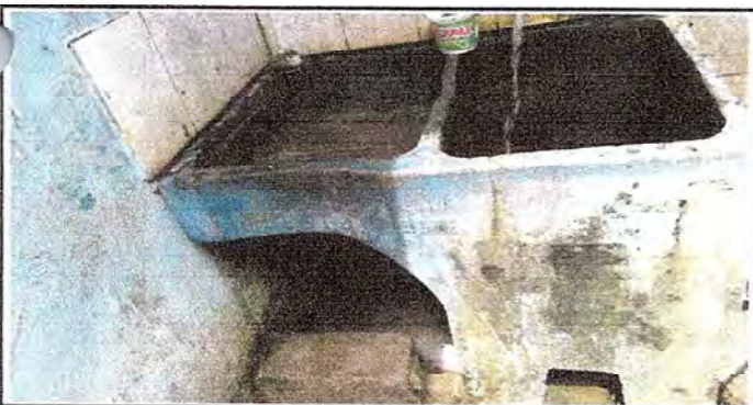
Foto 11: Se observa pila en mal estado
