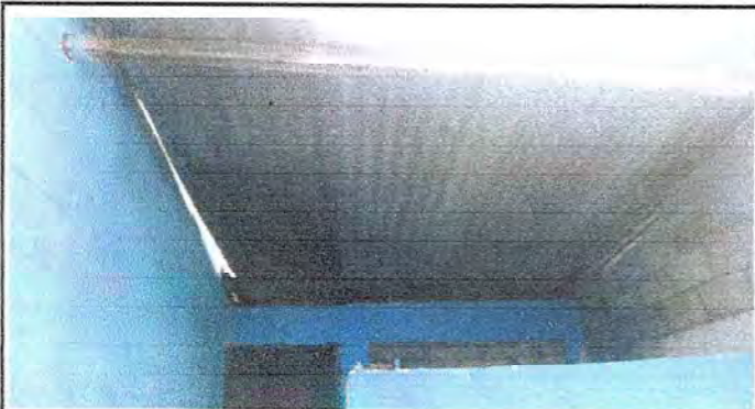
Foto 9: Se observa techo de lámina en mal estado
