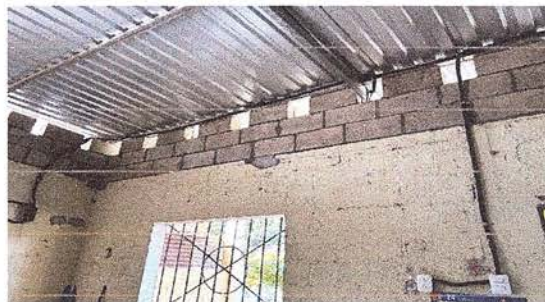
Foto 4: El sistema eléctrico finalizado
