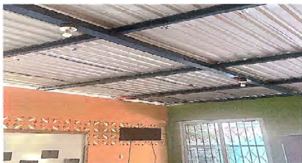
Foto 9: SE OBSERVA QUE SE ENCUENTRA INSTALADA LA RED ELÉCTRICA.
