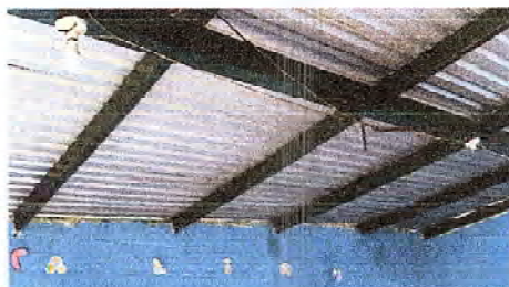
Foto 8: SE OBSERVA QUE LA LAMINA SE ENCUENTRA PICADA.
