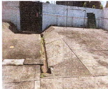
Foto 2: SE OBSERVA QUE SE NECESITA UNA BARANDA POR EL PELIGRO EXISTENTE.
