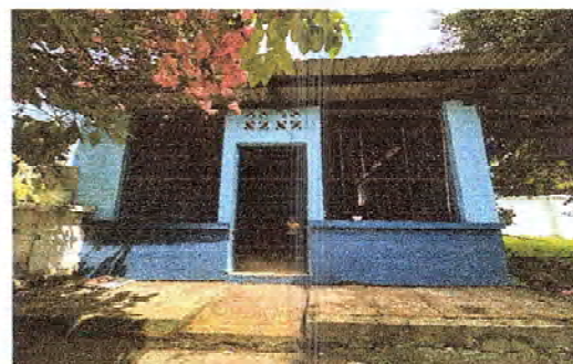
Foto 6: SE OBSERVA QUE NO SE CUENTA CON VENTANAS
