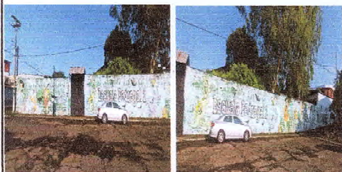
Foto 1: SE OBSERVA QUE LA PARTE DE ENFRENTA DE LA ESCUELA NECESITA SER PINTADA.
