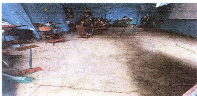
Foto 5: SE OBSERVA QUE SE NECESITA PISO CERAMICO EL AULA.
