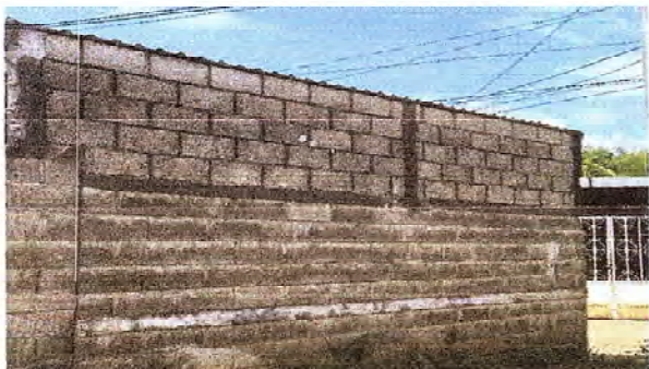
Foto 7: SE OBSERVA QUE NO SE CUENTA CON CANAL.
