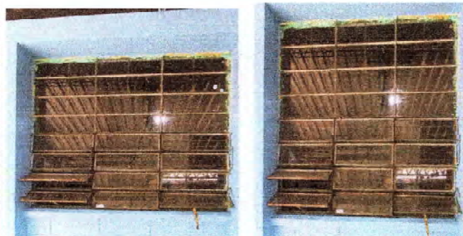
Foto 13: SE OBSERVA QUE SE ENCUENTRA EN MAL ESTADO LAS VENTANA Y NO SE CUENTA CON BALCÓN.
