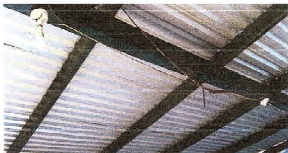
Foto 9: SE OBSERVA QUE SE NECESITA CAMBIAR EL SISTEMA ELÉCTRICO.
