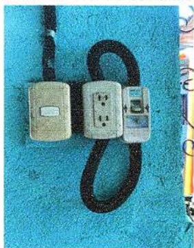
Foto 13: Se observa el sistema eléctrico colocado debidamente cubierto por una tubería para que se aisle por cuestión de seguridad
