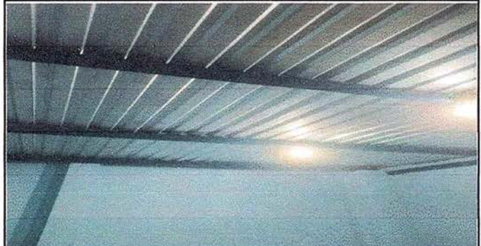
Foto 4: SE OBSERVA QUE SE HUBO SUSTITUCIÓN DE LÁMINA Y ESTRUCTURA METÁLICA.
