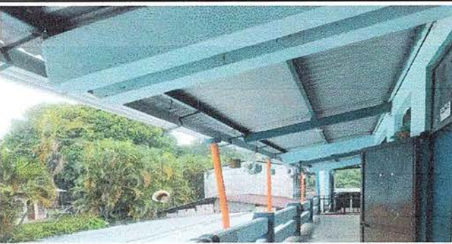
Foto 3: SE OBSERVA QUE EL CANAL SE SUSTITUYO, POR UNO MAS GRANDE
