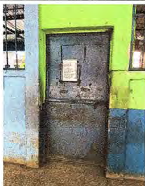
Foto 3: Se observa la acumulación de óxido y unas imperfecciones
