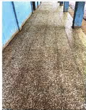
Foto 1: Se observa el piso en mal estado y desgastes en piso por agua acumulada
