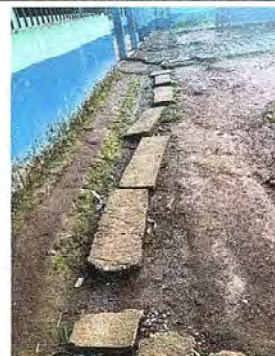
Foto 4: Se observa que no cuenta con torta de concreto para unir aulas y los niños se tropiezan con obstáculos
