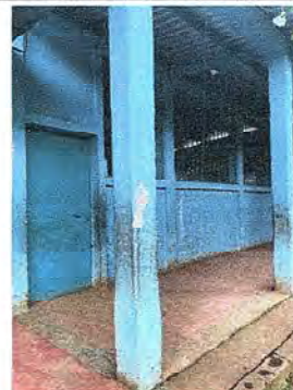
Foto 10: Se observa el mal estado de la pintura
