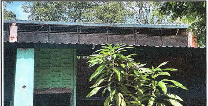
Foto 12: Se observa el mal estado y por el area los ladrones tienden a meterse por esa area
