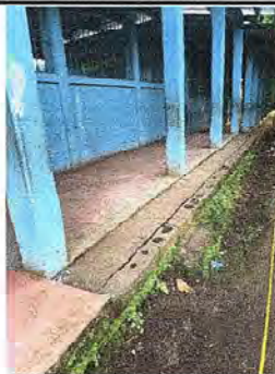
Foto 11: Se observa que la banqueta existente se encuentra undida y en mal estado
