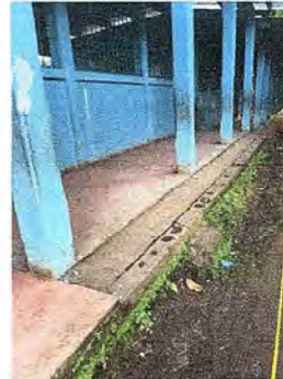
Foto 8: Se observa que el agua no cuenta con cuneta y tiende a derramarse en todo el area
