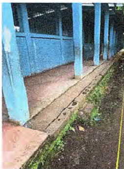
Foto 9: Se observa que al poner la cuneta de concreto se necesita poner una parrilla de metal para evitar accidentes
