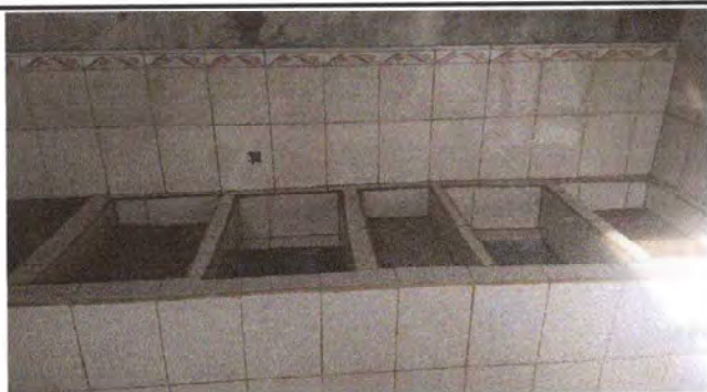
FOTO 1.3: SE OBSERVA QUE SE MEJORÓ EL ESTADO DE LA PILA
