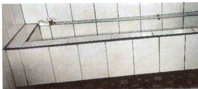
FOTO 1.3: SE OBSERVA QUE SE INICIÓ CON LA COLOCACIÓN DEL AZULEJO Y HACE FALTAN LOS CHORROS, PARA CONCLUIR LA REPARACIÓN.
