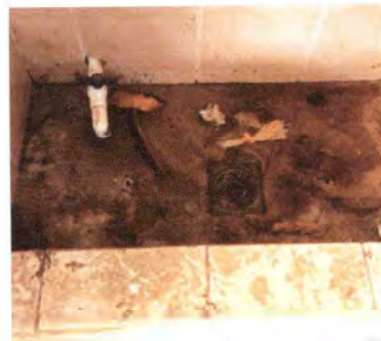
FOTO 1.2 AUN NO SE HAN INICIADO LOS TRABAJOS DE REPARACIÓN DEL MINGITORIO
