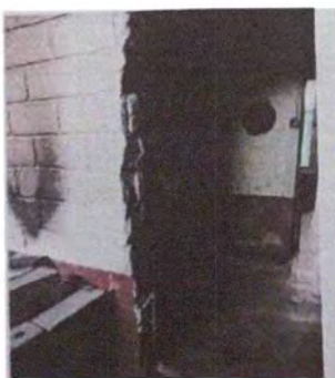
FOTO 2.7: AUN NO SE INICIA CON LA REPARACIÓN DE PARED
