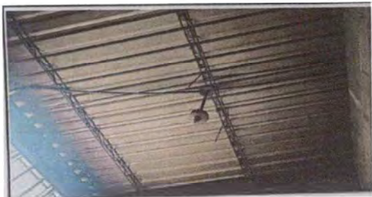
FOTO 2.5: AUN NO SE HAN INICIADO LOS TRABAJOS DE SUSTITUCIÓN DE SISTEMA ELÉCTRICO.
