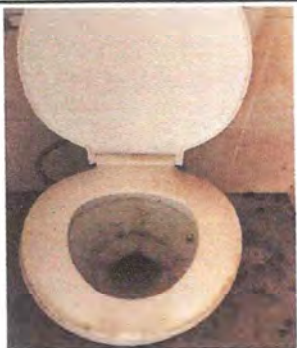
FOTO1.1: SE OBSERVA QUE EL INODORO NECESITA REPARACIÓN
