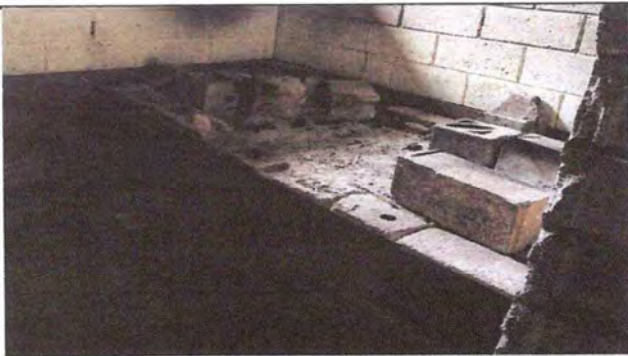
FOTO2.1: SE OBSERVA SUSTITUCION DE ESTUFA RURAL
