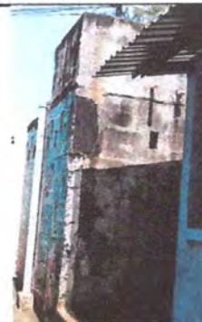
FOTO1.4: SE OBSERVA QUE SE NECESITA REPARACION DE MURO DE BLOCK DE CONCRETO
