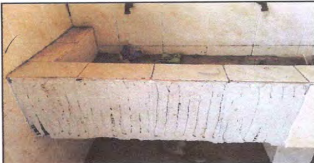
FOTO1.3: SE OBSERVA QUE SE NECESITA REPARACION DE ESTACION DE LAVAMANOS
