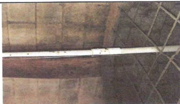
FOTO1.5: SE OBSERVA QUE NO FUNCIONA ADECUADAMENTE LÍNEA PRINCIPAL DE AGUA Y SE NECESITA UNA LLAVE DE PASO
