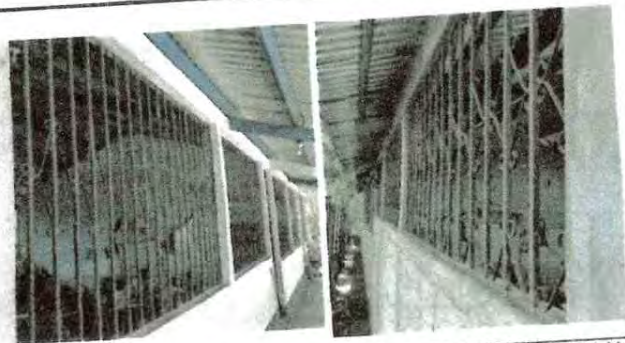
Foto 3: Se Observa la necesidad de darle mantenimiento a los balcones de metal debido a un alto nivel de corrosión, esto es en los dos módulos, cada modulo consta de tres aulas y una bodega, todas con balcones.
