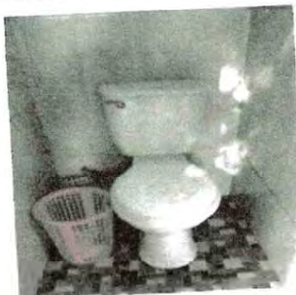
Foto 7: Se observa la necesidad de darle mantenimiento a los inodoros en relación a los equipos internos porque por el uso ya los equipos se arruinaron lo que ocasiona que el agua se vaya de manera constante.
