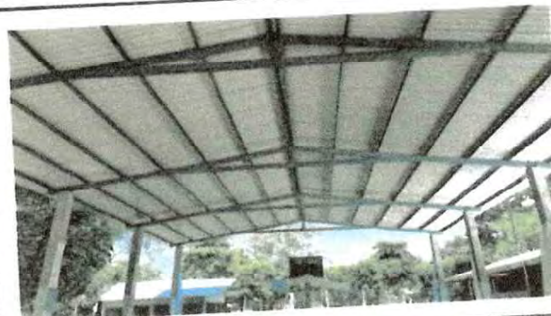
Foto 10: Se Observa la Necesidad del suministro de iluminación, esto debido a que la iluminación con la que cuenta es bastante precaria y no es apta para este resinto.
