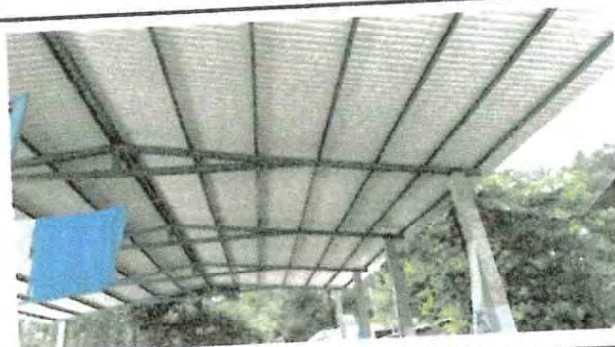
Foto 12: Se observa la necesidad de intalar canales con caídas de agua de 3"
