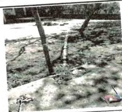
Foto 6: Se observa la necesidad de cambio de tubería de drenaje, esto debido a la erosión del terreno ha dejado al descubierto la tubería del drenaje lo que ocasionó que se quebrara.
