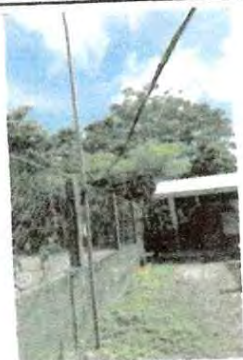
foto 13: se observa la necesidad de cambiar el suministro de energía eléctrica
