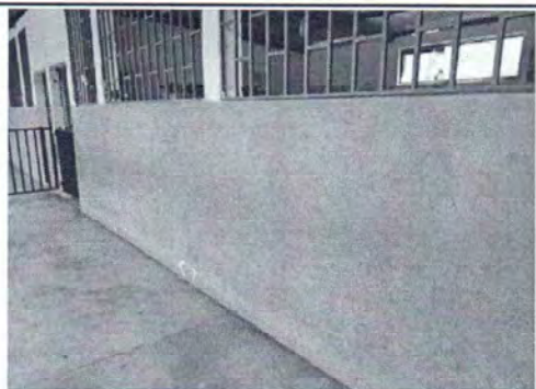
Foto 9: Se observa que muros necesitan mantenimiento preventivo.
