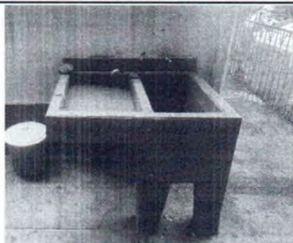
FOTO 9: SE OBSERVA EL DETERIORO DE LA PILA, URGE EL CAMBIO.
