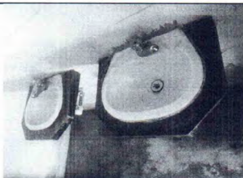
FOTO 15: SE OBSERVA QUE NO FUNCIONA EL SISTEMA DE MANECILLAS Y MANGUERAS, URGE CAMBIARLO.
