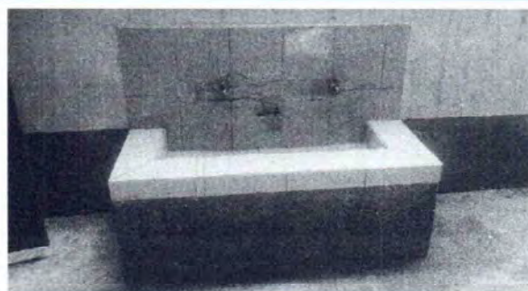
FOTO 8: SE OBSERVA EL DETERIORO Y MAL FUNCIONAMIENTO DE LOS CHORROS.
