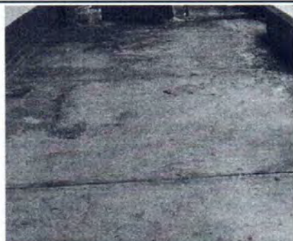
FOTO 4: SE OBSERVA EL PISO RÚSTICO ES NECESARIO COLOCAR PISO ANTIDESLIZANTE.
