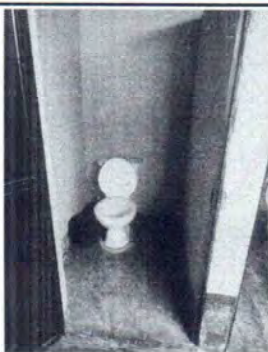
FOTO 7: SE OBSERVA EL MAL ESTADO DE LOS BAÑOS, EL PISO ES RÚSTICO, URGE PISO ANTIDESLIZANTE Y LA PAREDES SUCIAS Y SIN AZULEJO.
