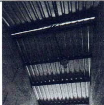
FOTO 14: SE OBSERVA QUE NO FUNCIONA EL SISTEMA ELÉCTRICO, URGE CAMBIARLO.
