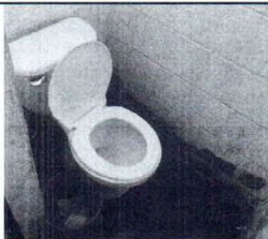
FOTO 11: SE OBSERVA EL MAL ESTADO DE LOS BAÑOS, EL PISO ES RÚSTICO, URGE PISO ANTIDESLIZANTE Y AZULEJO.
