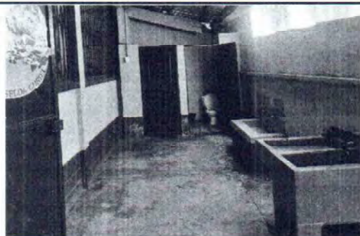
FOTO 5: SE OBSERVA LA PAREDES SUCIAS Y SIN PINTURA.
