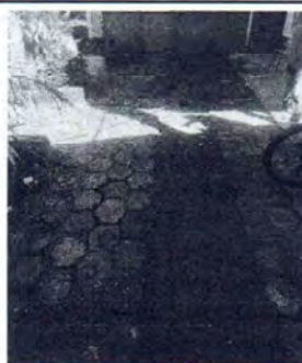
FOTO 2: SE OBSERVA ADOQUINES AL INGRESAR AL CENTRO EDUCATIVO, ES NECESARIO UNA PLANCHA DE CONCRETO.
