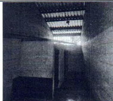
FOTO 12: SE OBSERVA LA PAREDES SUCIAS Y SIN PINTURA.
