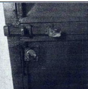
FOTO 16: SE OBSERVA EL MAL ESTADO DE LAS CHAPAS DE LA PUERTA.
