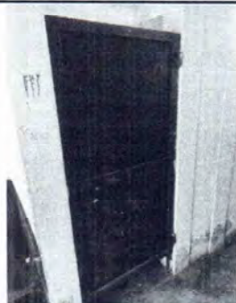
FOTO 13: SE OBSERVA EL ÓXIDO Y FALTA DE PINTURA EN LAS PUERTAS, URGE DARLE MANTENIMIENTO.
