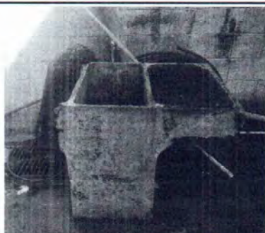
FOTO 17: SE OBSERVA EL DETERIORO DE LA PILA, URGE EL CAMBIO.
