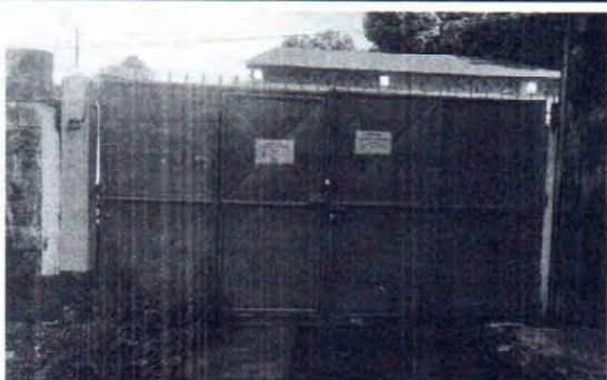
FOTO 1: SE OBSERVA ÓXIDO Y DETERIORO EN EL PORTÓN DE INGRESO AL CENTRO EDUCATIVO, URGE SUSTITUCIÓN.
