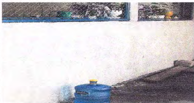
Foto 11: Se observa que los muros necesitan cernido.
