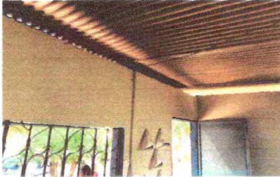
Foto 1: Se observa la necesidad de la Conformación de muro de cocina debido a que el techado esta muy bajo
