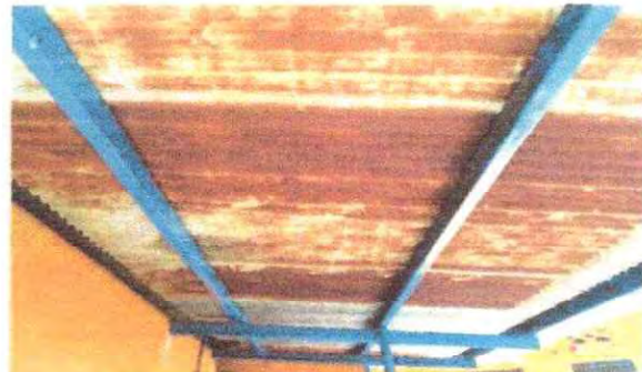
Foto 4: Se observa que la laminas de la cocina necesitan cambio por el mal estado
