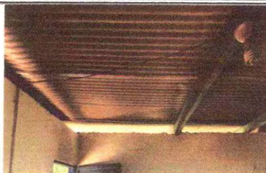
Foto 8: Se observa la necesidad de darle mantenimiento a la estructura de soporte de metal
