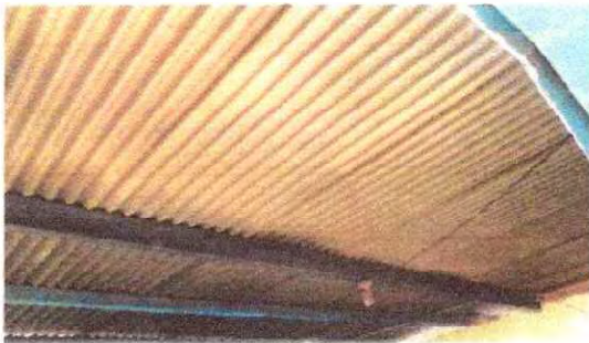
Foto 3: Se observa la necesidad del cambio de estructura metalica debido la la mejora de la cocina
