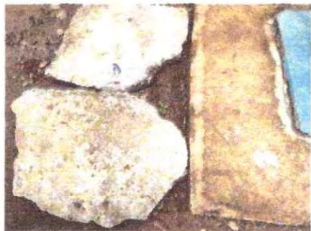
Foto 13: Se observa la necesidad de reparar el concreto en el patio, para mantener el ambiente agradable para los estudiantes
