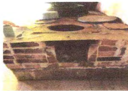
Foto 2: Se observa que la estufa rural no cuenta con puertas o tapadera para evitar la salida de humo
